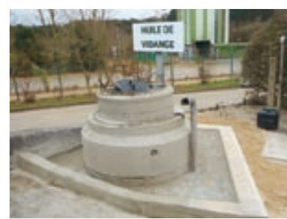
Rétention autour de la cuve d'huile de vidange à Kerdanvez.
