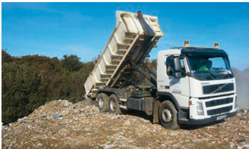
Dépôt de déchets inertes sur le site de Kerdanvez.
