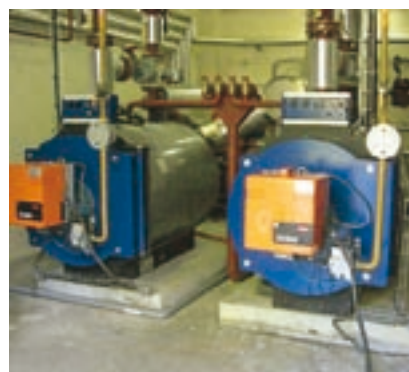
Les chaudières de la piscine consomment 99 t de gaz par an.
